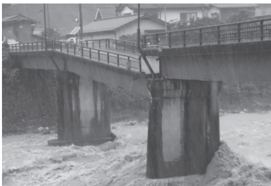
令和2年7月豪雨 南信濃中橋(遠山川) 橋げた落下
